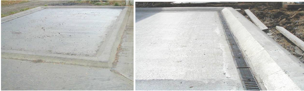
Fig. 16 & 17: Afzonderlijke vul- en spoelplaats waarbij de gecontamineerde vloeistoffen via een goot in de beton (links) of afvoerrooster (rechts) naar het biozuiveringssysteem worden geleid (Bron: ADAS)
